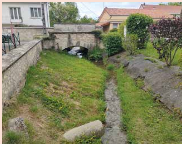
Tracé du cours d'eau à réaxer afin d'éviter l'érosion
