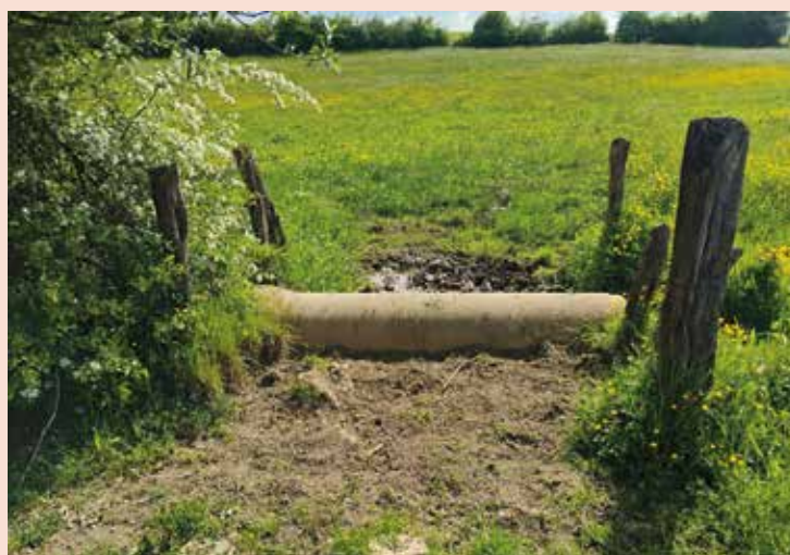
Buse à remplacer par un passage à gué
